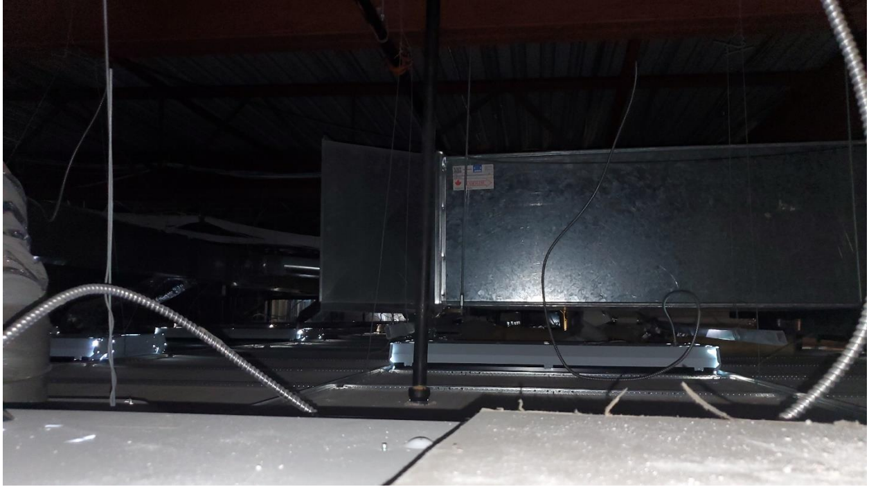
Photo A3 : Plenum return
